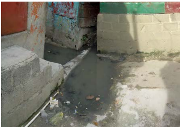
Ilustración 5.21 En la zona 13 frecuentemente hay problemas con inundaciones.
