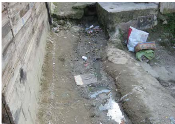
Ilustración 5.24 La zona 23 está ubicada al pie de escalera y el pavimento está degradado.
