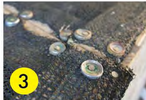
Se clavó la maya con tapas para que no se la rompa. They nailed the netting with caps so that it won't rip.
