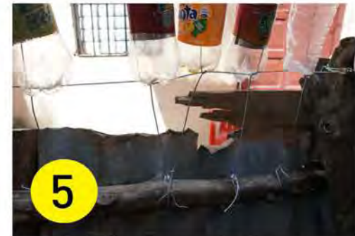
La técnica de afijar las cadenas de botellas al muro. The technique for attaching the bottle chains to the wall.
