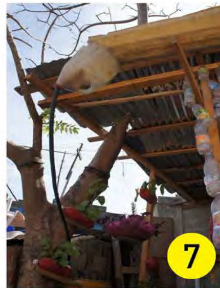
El caño y la manguera juntan lluvia del techo. The gutter and hose gather water from the roof.
