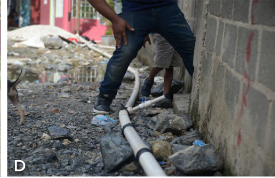
D Tubo de agua potable, realizado por la CAASD. Fresh water pipe installed by the CAASD.
