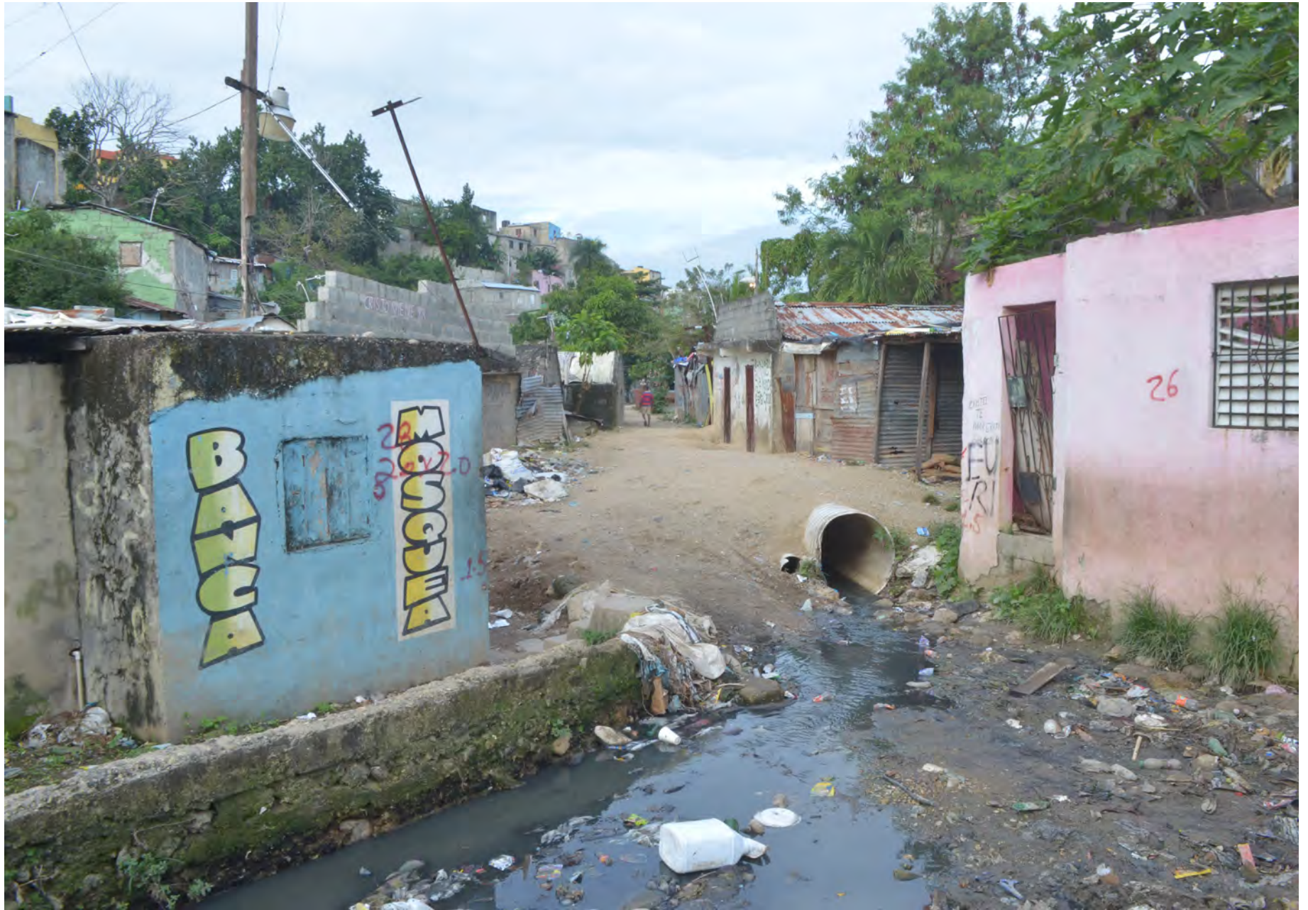
Ilustración 3.3 En los lugares sin entubar todavía estaba la cañada abierta en el 2018, lo que permitía que desechos entrara la tubería.
