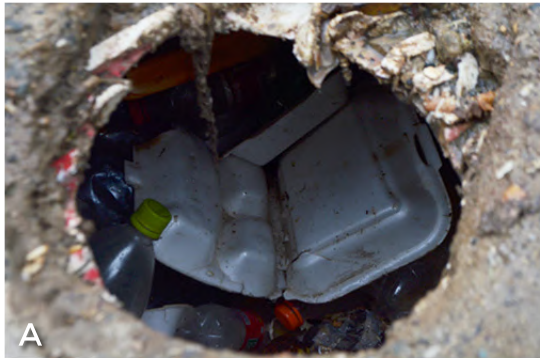
A En estos orificios hechos por los vecinos se ve la acumulación de basura en la tubería. Garbage accumulations are visible through these openings.
