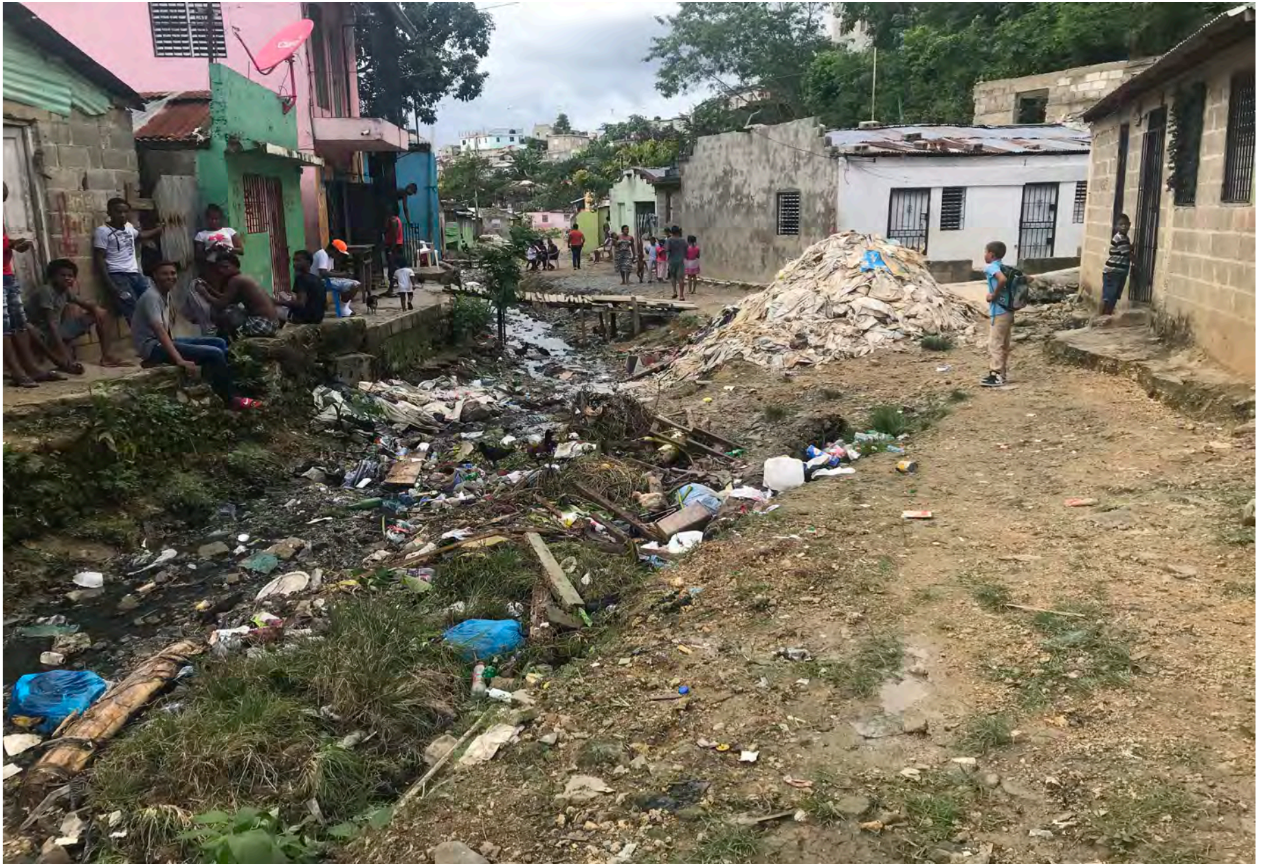
Ilustración 1.4 Casas demolidas durante el proceso de la construcción de tubería para aguas superficiales, 2018.
