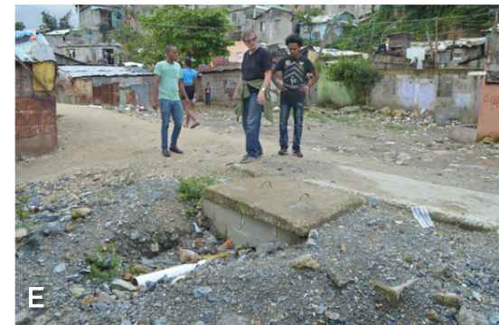
E Registro realizado por la CAASD. Drainage trap installed by the CAASD.
