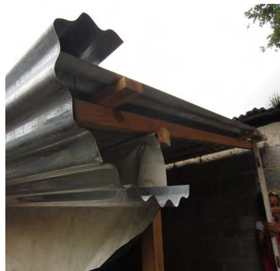
Ilustración 6.4 Una mirada de cerca del sistema de canalización instalado por la comunidad.
