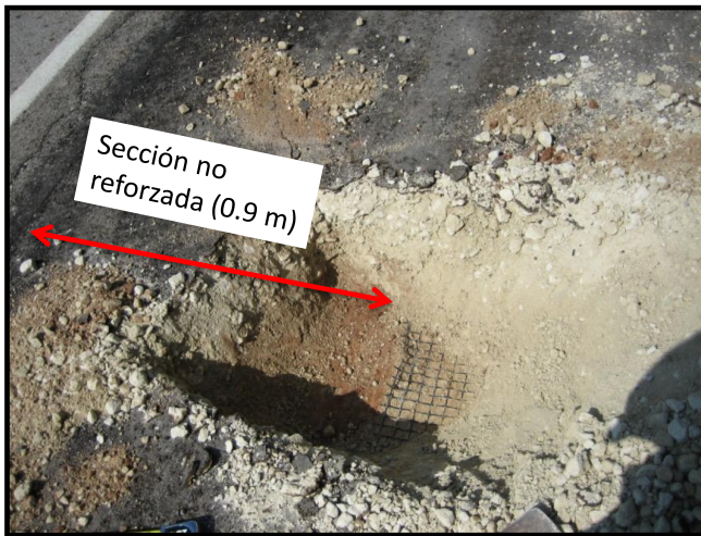
Figura 5: Vista del borde de la geomalla de refuerzo directamente debajo de una grieta longitudinal.
